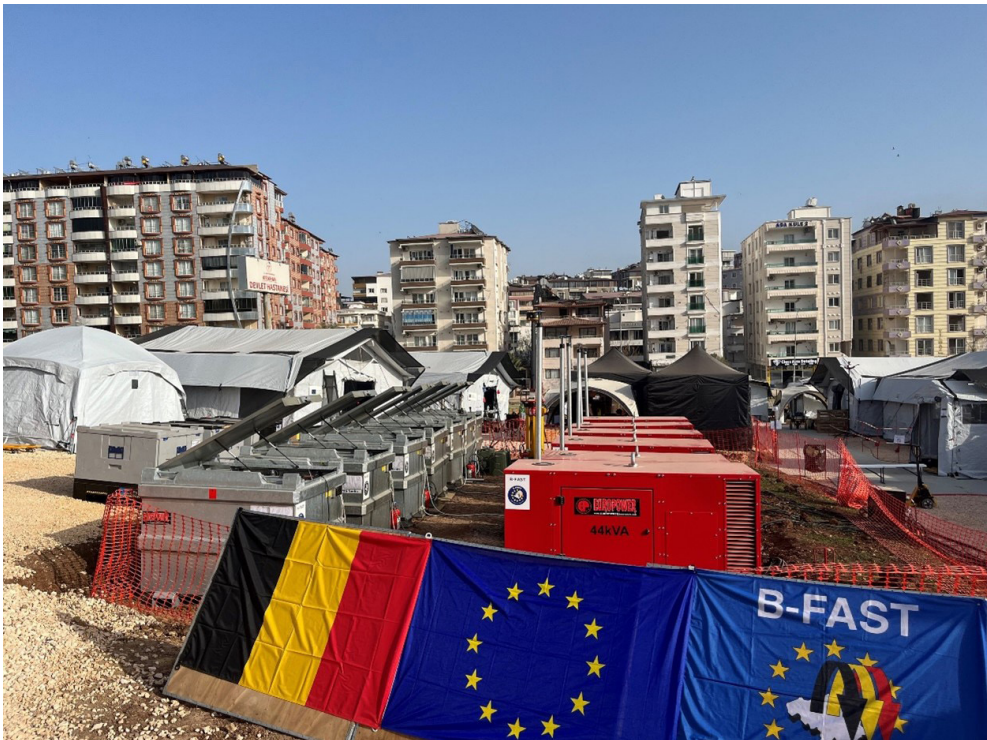
De 'elektriciteitscentrale' – Zes dieselgeneratoren voeden zeven gigantische batterijen die betrouwbare stroom aan het Emergency Medical Team (EMT) leveren.
